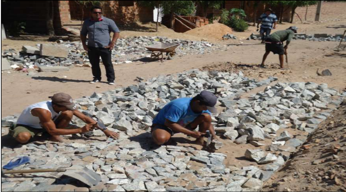
Figura 19 – Falta de Equipamentos de Proteção Individual - EPI
