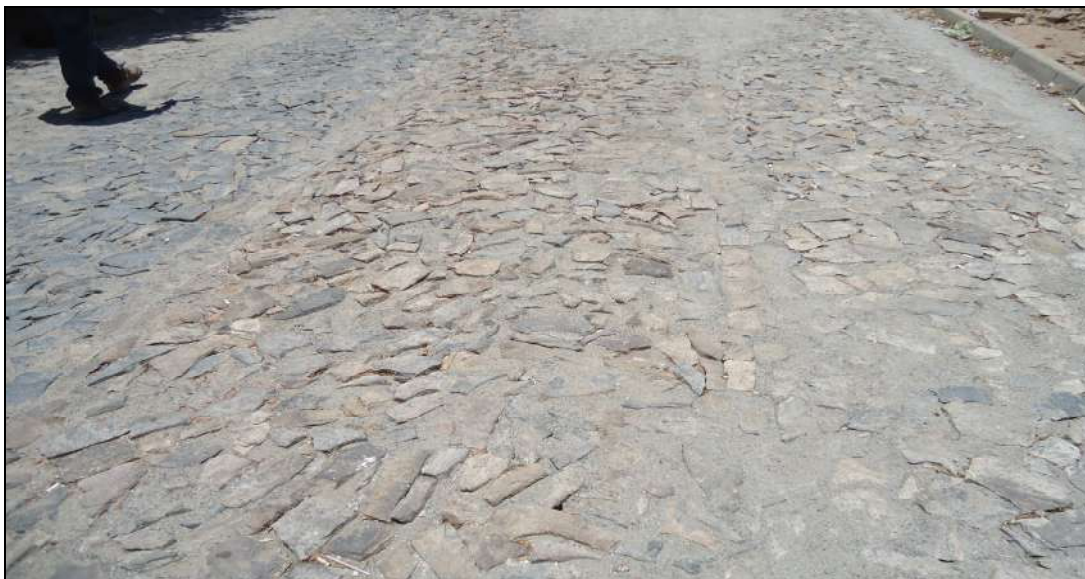
Figura 14 – Pavimentação Executada sem Rejuntamento na Rua Fco. Odeon Silva, na Comunidade de Bailarina
