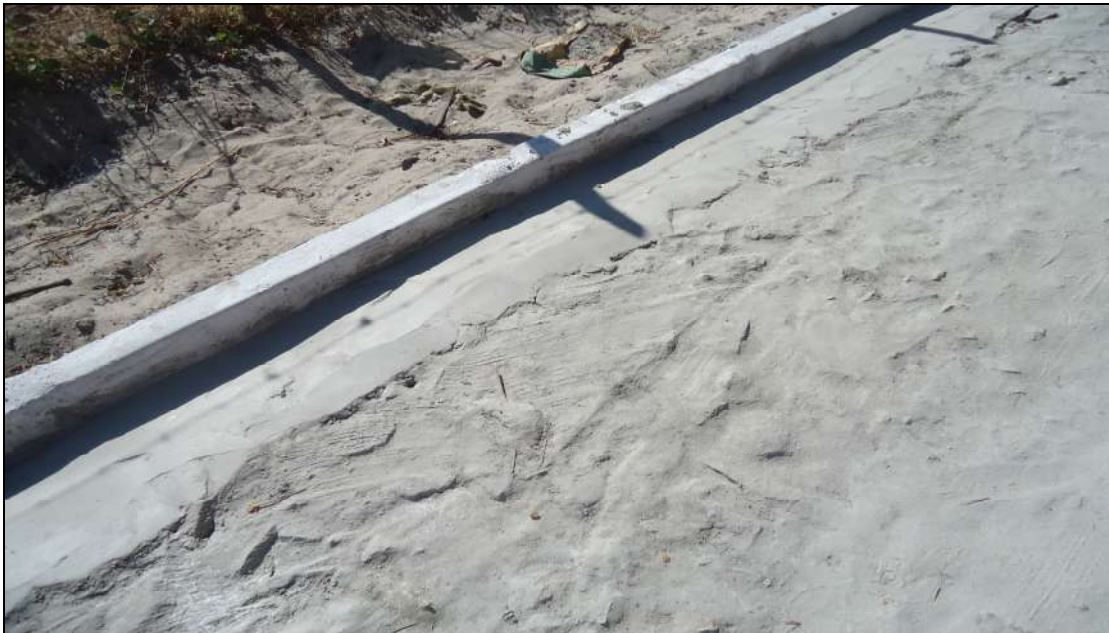
Figura 18 – Sarjeta com Desconformidade na Largura na Rua Frutuoso José Vasconcelos
