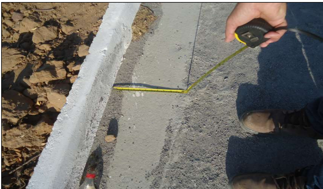
Figura 17 – Largura da Sarjeta em Ruas da Localidade Santa Fé é Inferior à Prevista no Projeto e no Orçamento
