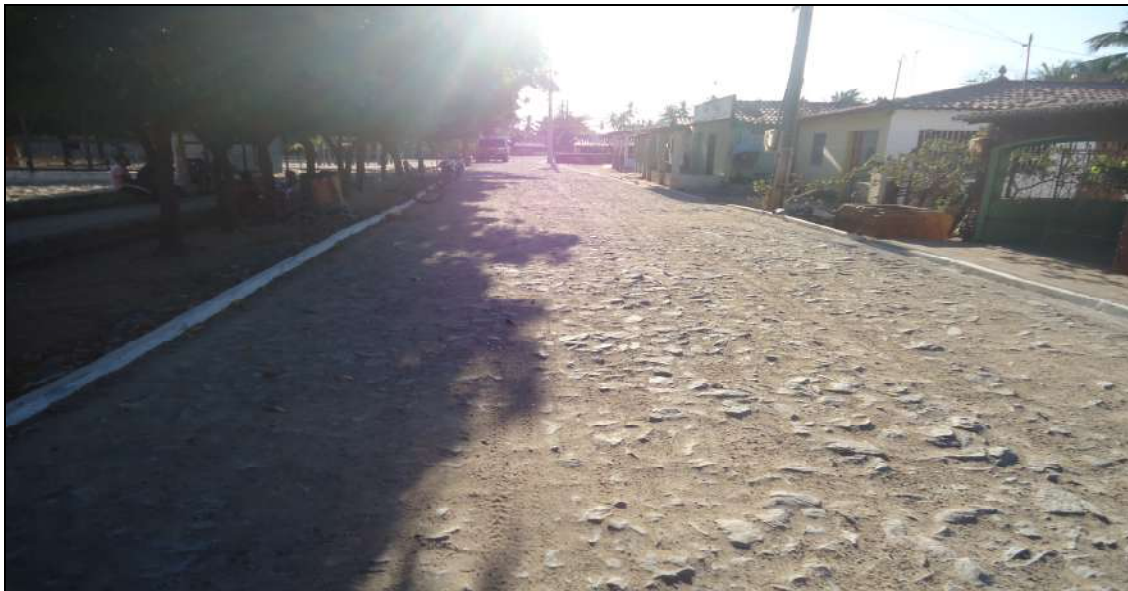
Figura 12 – Compactação Insuficiente com Pedras Aflorando e Ondulações
