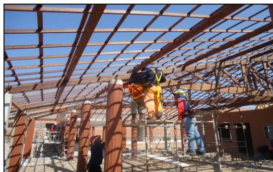
Trabalhador com cinto de segurança, mas sem fixação em suporte para prevenir quedas
