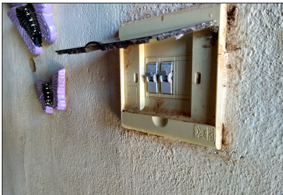
Figura 9 – Quadro de Distribuição
