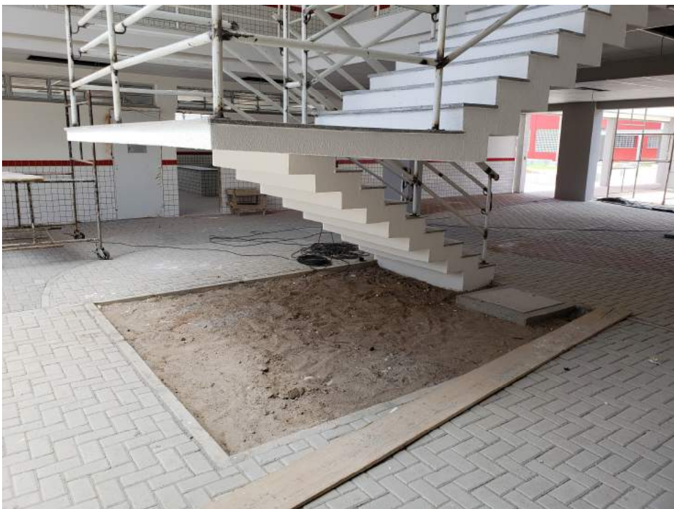
Figura 25 – Ausência de execução de piso intertravado
