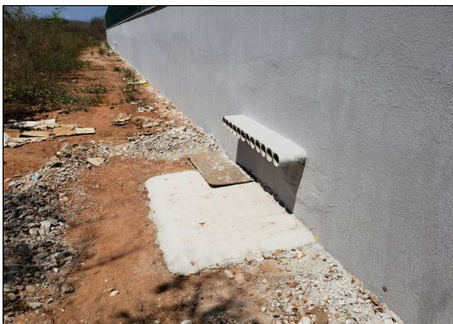
Figura 21 – Lançamento de águas pluviais acima do nível da calçada
