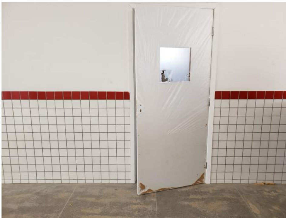
Figura 16 – Porta Instalada Fora das Especificações
