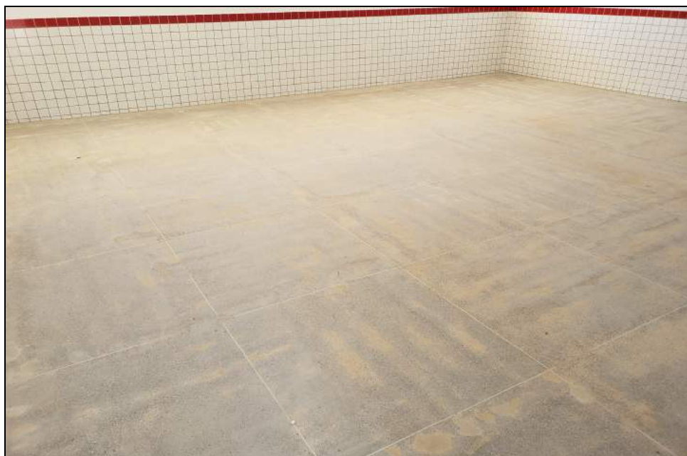
Figura 7 – Manchas amareladas no piso da sala de aula
