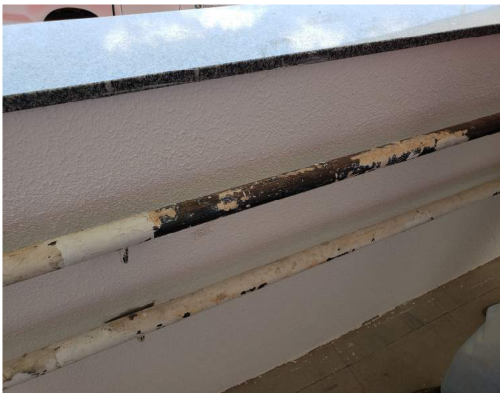
Figura 14 – Presença de oxidação no tubo do guarda-corpo
