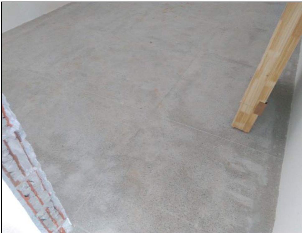
Figura 9 – Manchas escuras no piso da sala de coordenação de estágio
