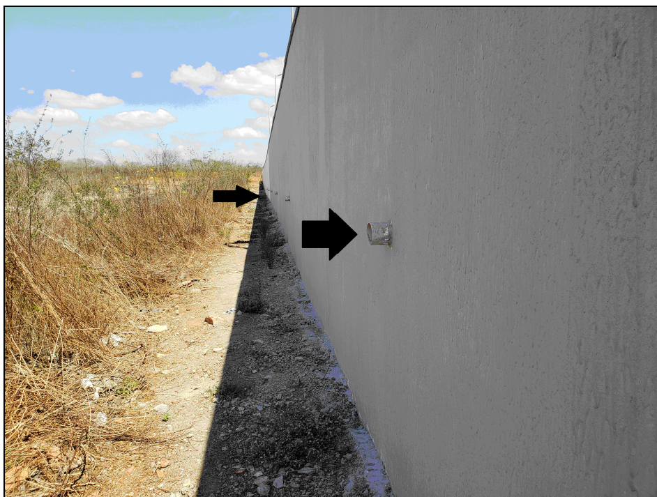
Figura 19 – Galeria executada com lançamento de águas pluviais para terreno de propriedade particular
