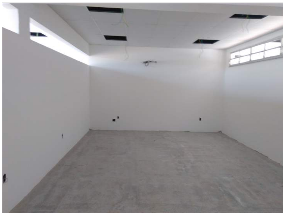
Figura 10 – Falta de acabamento nos cantos e polimento
