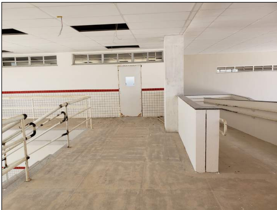
Figura 8 – Manchas amareladas no piso da circulação do pavimento superior
