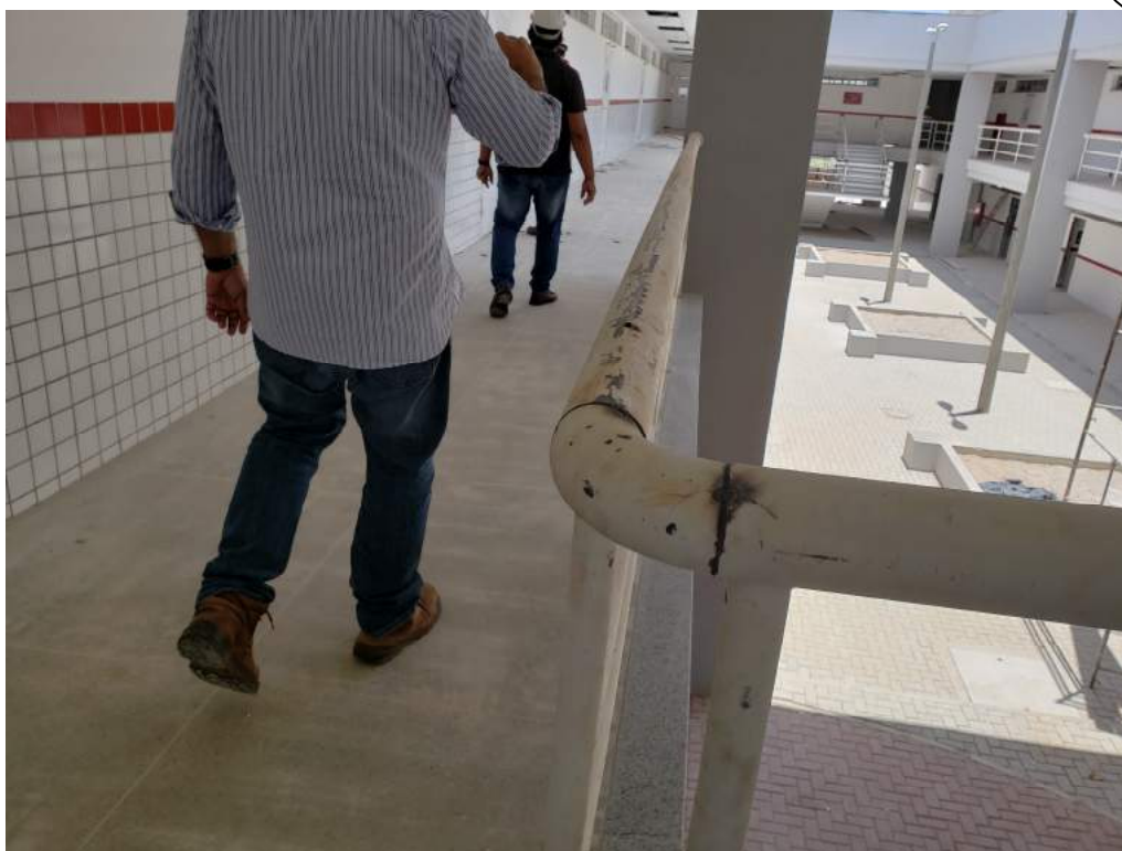
Figura 15 – Sinais de oxidação no tubo do corrimão
