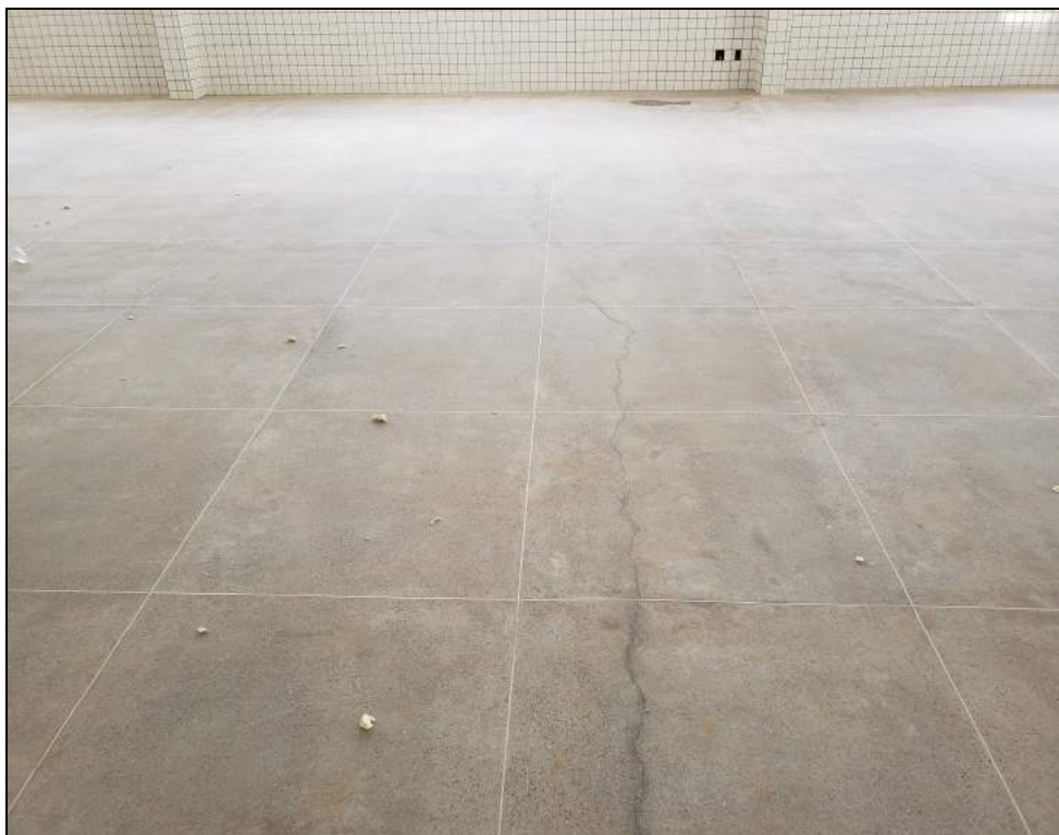
Figura 6 – Rachadura e abaulamento no piso
