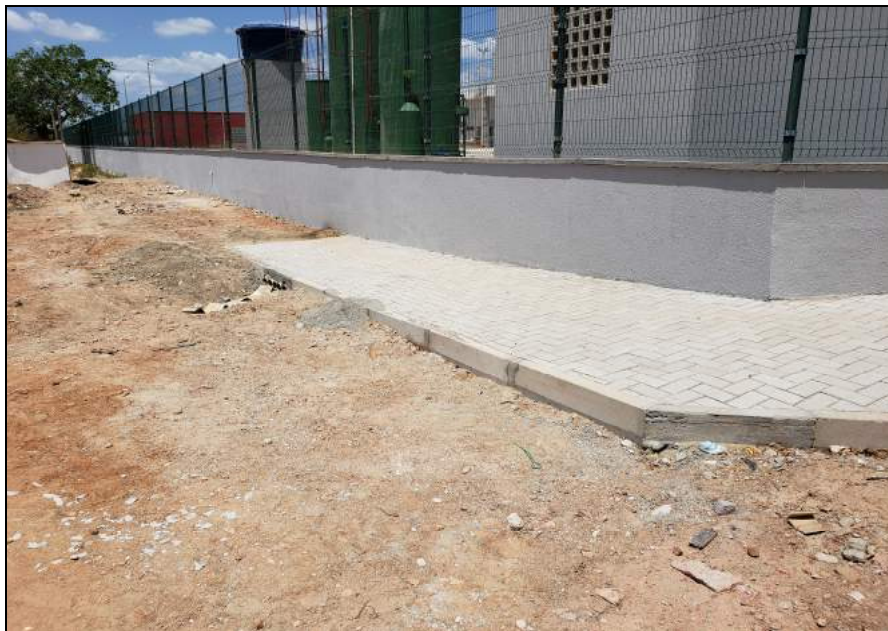
Figura 28 – Calçada lateral esquerda não foi executada
