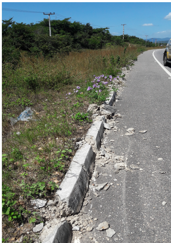
Figura 15 – Dispositivo de drenagem danificado
