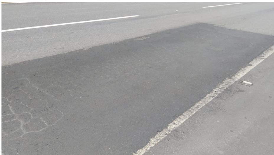
Figura 18 – Remendo com afundamento e trincas em malha tipo “couro de jacaré”
