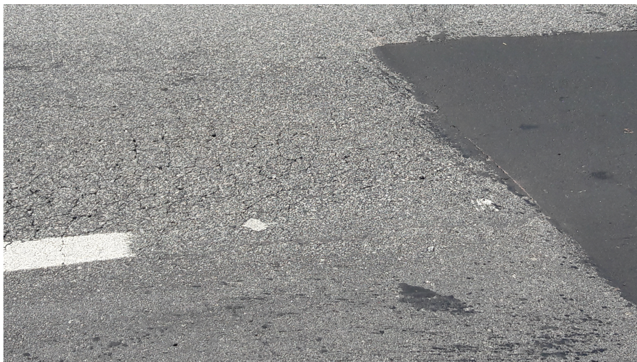
Figura 17 – Remendo e trincas em malha tipo “couro de jacaré”
